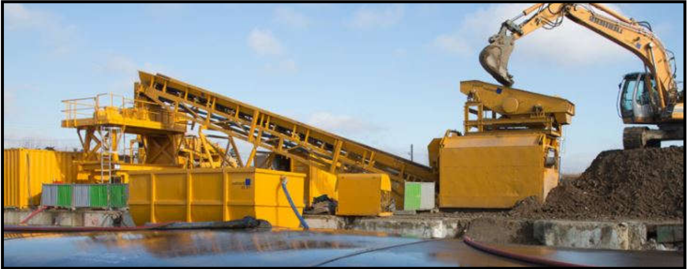
UNITE DE TRI, CRIBLAGE ET MALAXAGE Source : BREZILLON
